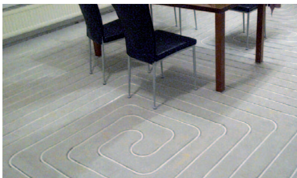
cuprotherm-Mini mit CTX-Rohren; Wohnräume weiterhin nutzbar
