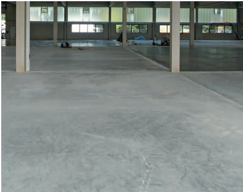
Fertig beheizbarer Industrieboden. Industrieflächenheizungen ermöglichen einen gleichmäßigen Temperaturverlauf über die gesamte Hallenfläche
