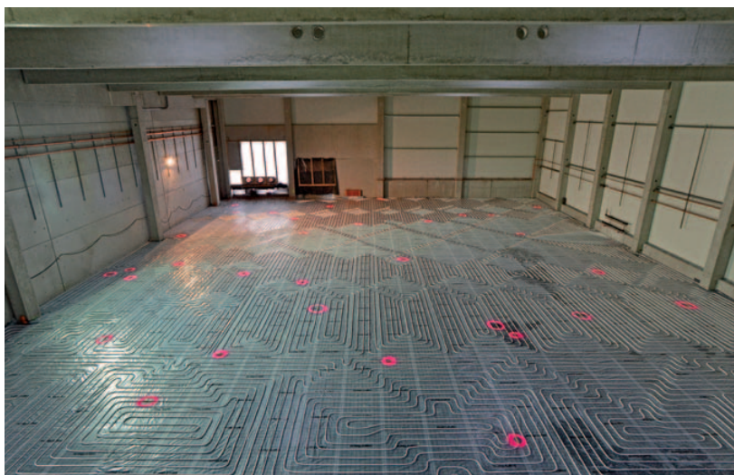
Die berechnete Teilfläche in der Umsetzung: 22 Heizkreise
