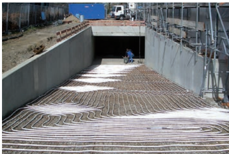
Freiflächenheizung Schneefreihaltung (Astra Unterföhring, CTX 20 x 2 mit CTX-Schiebehülse)
