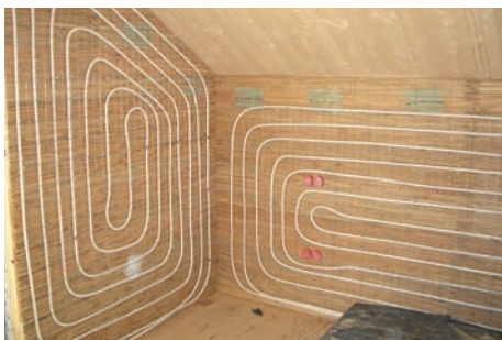
Wandheizung auf Schilfmatte mit Lehmputz (CTX 14 x 2)
