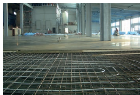
Industrieflächenheizung (erhöhte Verkehrslast, Karger GmbH Mertingen, CTX 16 x 2)
