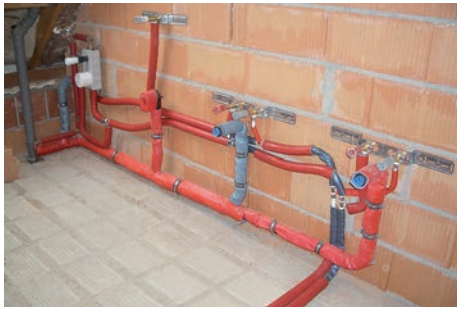
Sanitärinstallation (CTX 16 x 2 und 20 x 2)
